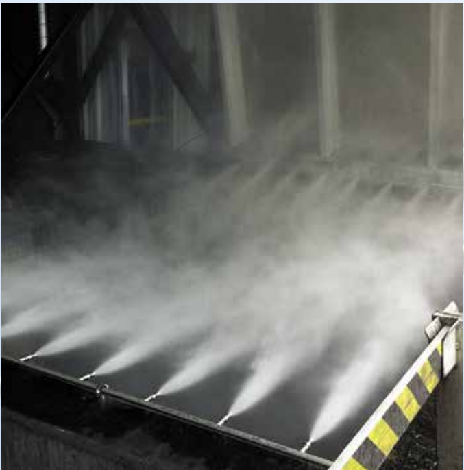
FESTINSTALLIERTE DÜSENLEITUNGEN ▪ Effektive Staubbindung direkt bei der Staubentstehung
