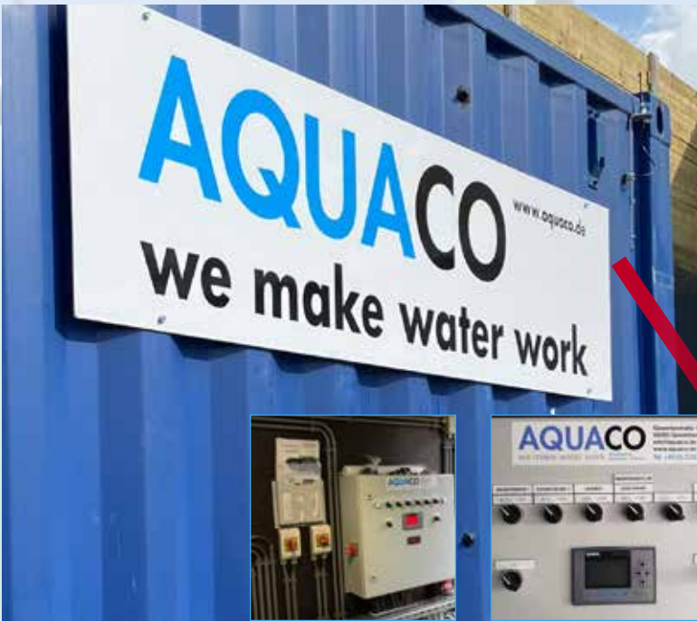
TECHNIK-CONTAINER ▪ Installationsbeispiel Pumpe und Steuerung für Nebelvorhang
