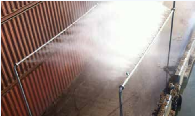
FESTINSTALLIERTE DÜSENLEITUNGEN ▪ Montage an Transportschleuse für LKW
