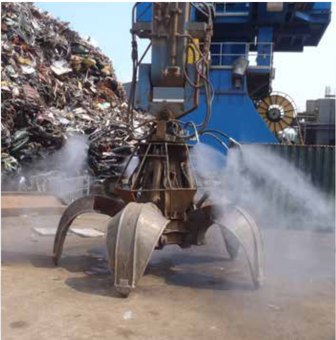
FESTINSTALLIERTE DÜSENLEITUNGEN ▪ Montage an Schrottgreifer
